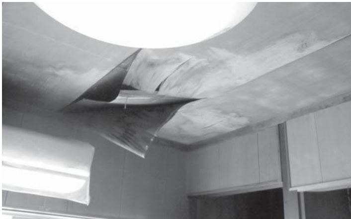
雨漏りで落ちた天井（横浜改良住宅）
