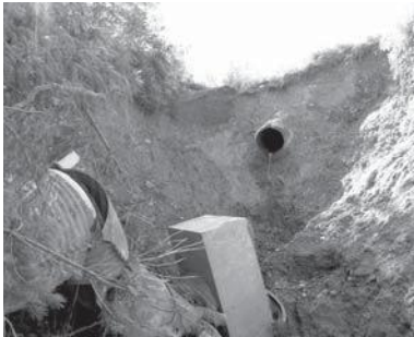
浮鞭農道の災害
