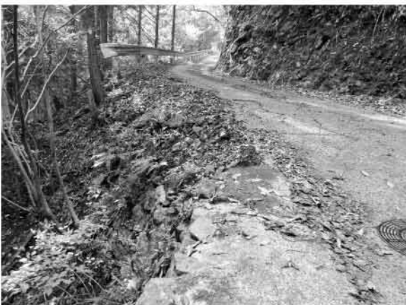
町道加持～橋川線危険箇所の一部
