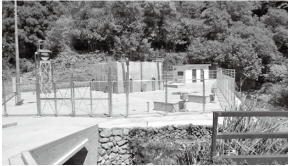
鈴地区簡易水道施設
